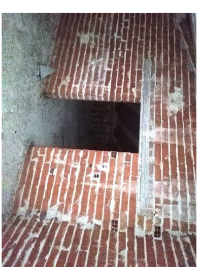
5 SOLAIO, Vista interna, sovrastante DIFETTO - Sostituzione non isolata Intervento "C" - Completamento scalo sovrastante
